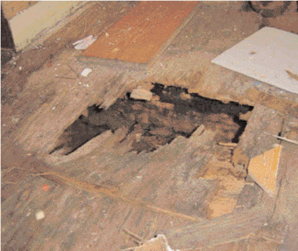
Dit was het resultaat nadat er vijftien jaar geen onderhoud was gepleegd... Niet alleen de vloerdelen waren verrot, ook was er veel roest zichtbaar op het vlak.
